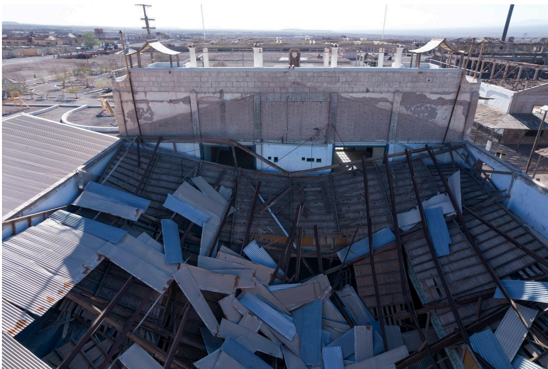
Imagen 11. Colapso de la techumbre del teatro (Archivo FA)
